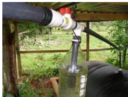
Fig. 15: Vista de válvula de seguridad
